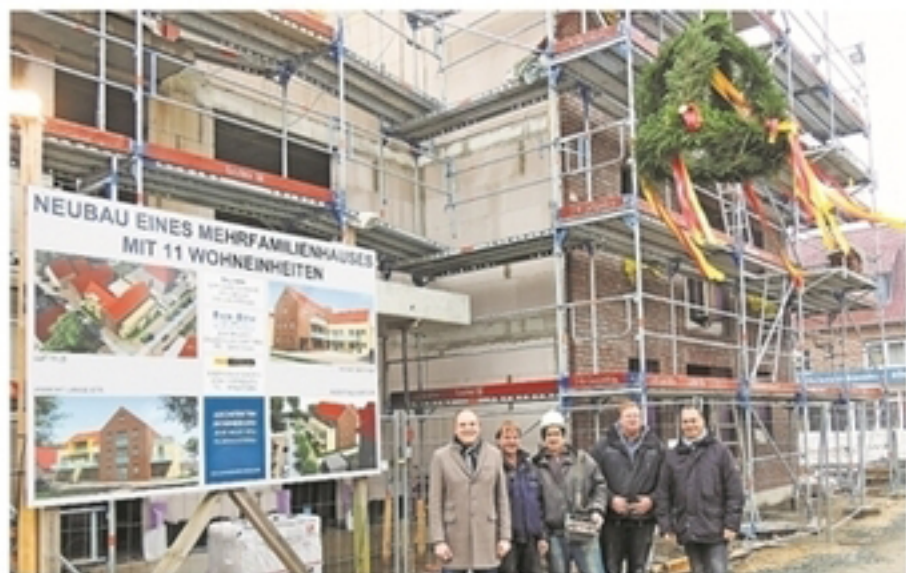
Richtfest beim Neubau am Ex-Griechen-Standort an der Ecke Lange Straße/Neumarktstraße: Bauherr Alexander Sparr, Polier Holger Weinhold, Kranführer Dirk Gresens, Jörg Viebrock von der Firma Landhausbau Glinstedt und der Bauherr Martin Breuer (von links).
